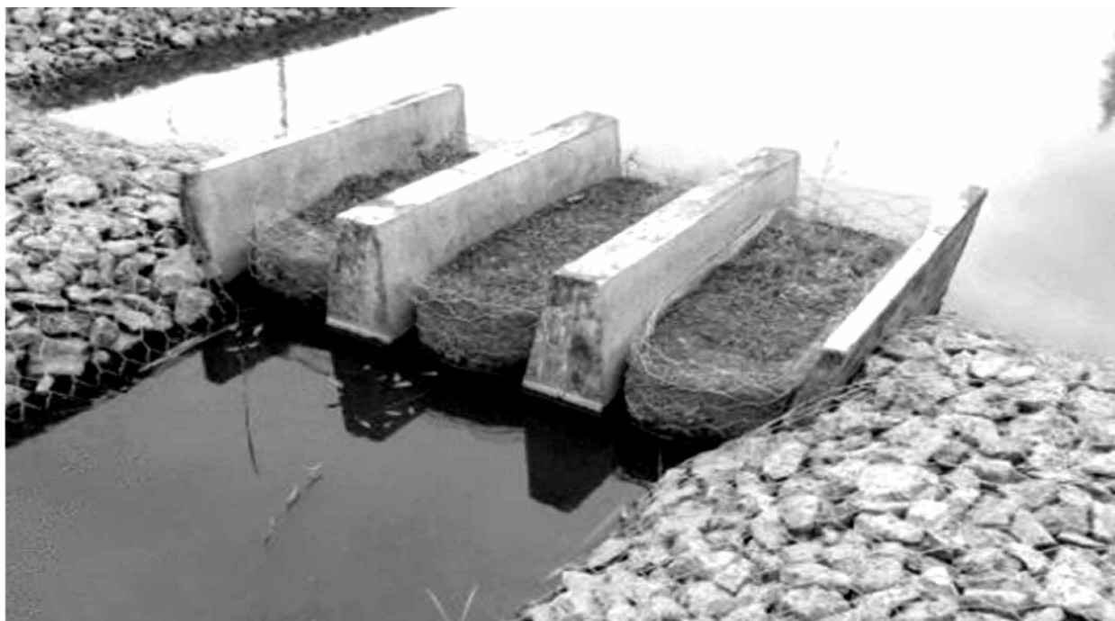
Рис. 4. Фильтрующие кассеты для очистки поверхностных вод Fig. 4. Filter cassettes for surface water treatment
