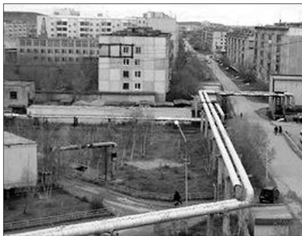
Рис. 2. Бытовые трубопроводы в г. Якутске
